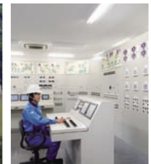
全工程を管理するコントロールセンター
